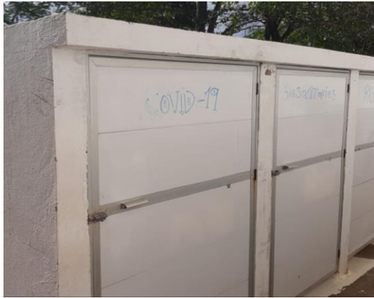
Imagen N° 34. Almacenamiento Temporal Aislamiento COVID-19
