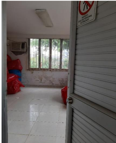
Imagen N° 40. Almacenamiento Central Peligroso 1
