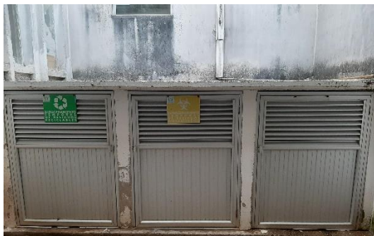
Imagen N° 26. Almacenamiento Temporal Consulta Externa
