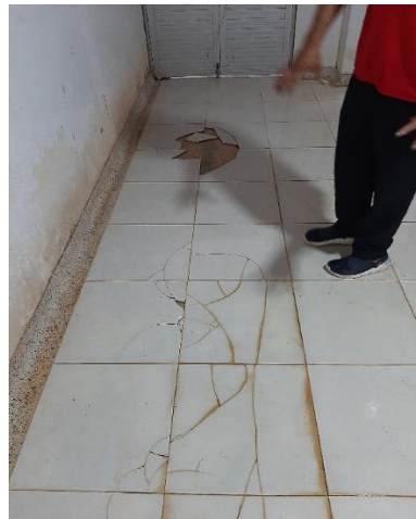
Imagen N° 43. Almacenamiento Central Peligroso 4
