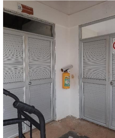
Imagen N° 41. Almacenamiento Central Peligroso 2
